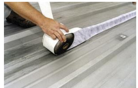
Beschichtung mit faserhaltigem Alu-Roof coating ist rißüberbrückend und isoliert. Wulste werden zuerst separat abgedichtet.
