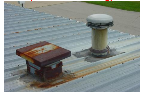
Alu Dächer – aber vor allem Metalldächer (Blechdächer) beginnen zu rosten. Und werden dadurch undicht – wenn nicht zeitgerecht beschichtet.
