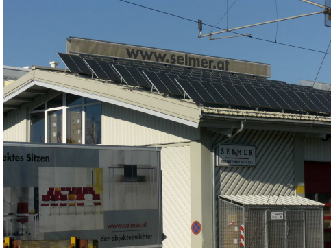
Selmer Objekteinrichtungen Seekirchen 120 Paneele (~ 84 m 2 ) PV-Anlage – Alter ca. 10 Jahre Problem: Ruß + Schienenstaub
