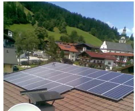
E-Werk Stadler Wildschönau 5 KWp (~ 40 m 2 ) PV-Anlage
